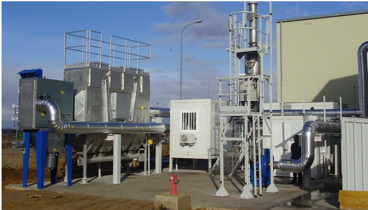
Figura 2 Detalle del sistema de depuración híbrido (electrofiltro + filtro de mangas) ubicada en las instalaciones de CEDER-CIEMAT.
